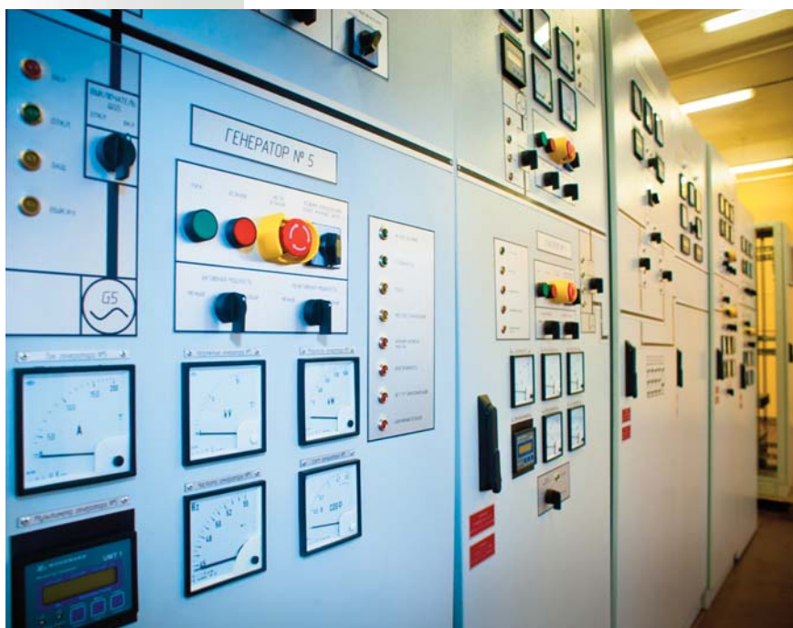
Фото 1. Панели резервного управления энергоблоками
