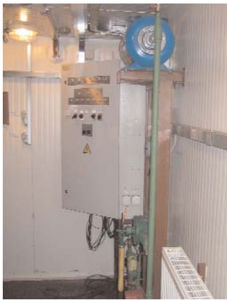
Шкаф управления электростанцией
