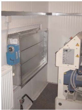
Жалюзи воздухозаборного устройства системы воздухоподачи (слева)
